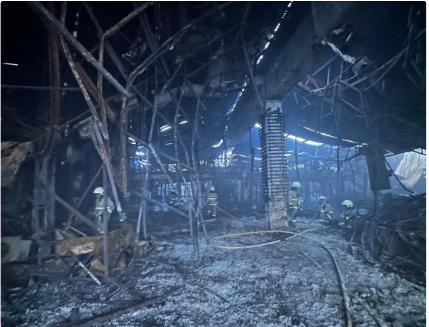
Glodok Plaza yang Hangus Terbakar
